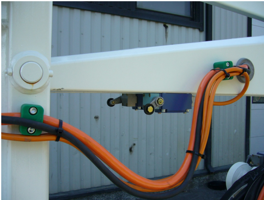
Kuva 7: Työtason asemanvalvonnan rajakytkimet.
