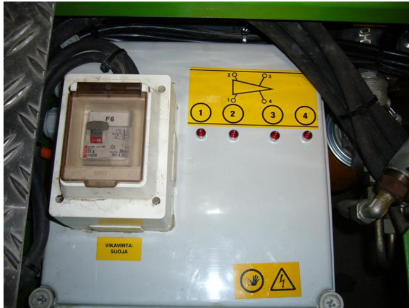
Kuva 12: Tukijalkojen rajakytkinten merkkivalot.
